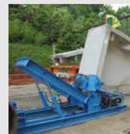
Inclinação de quadros
