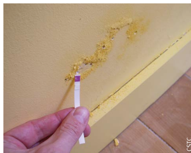
Fig. 27 Décollement et pulvérulence des finitions intérieures en pied de mur, résultant de l'action de nitrates (comme le montre la bandelette indicative; voir § 3.1.4, p. 28).
