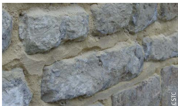
Fig. 1 Pulvérisation des joints de mortier dans un mur de maçonnerie. Dans le cas concerné, les symptômes relevés sont dus à l'hygroscopicité et à la cristallisation de sels solubles qui ont pénétré dans la maçonnerie à la suite du stockage d'engrais chimiques.
