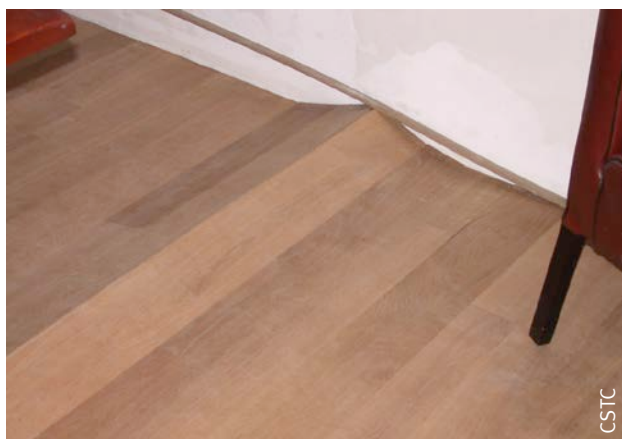
Fig. 15 Soulèvement d'un parquet. Les symptômes constatés découlent d'un taux d'humidité élevé dans la chape sous-jacente.
