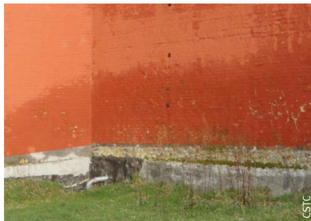
Fig. 6 Tache d'humidité se manifestant sur un badigeon extérieur et fluctuant en fonction de l'humidité relative ambiante. Les symptômes décelés sont engendrés par les sels hygroscopiques contenus dans la maçonnerie sous-jacente.
