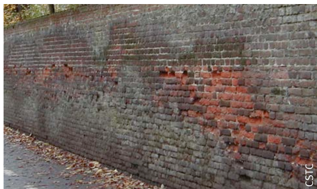
Fig. 3 Pulvérisation des briques et des joints de mortier dans un mur de clôture en contact avec les terres. Les symptômes observés sont ici dus à la cristallisation de sels solubles dans la maçonnerie (en particulier dans la partie supérieure de la zone humide) et à l'action des cycles de gel-dégel sur la maçonnerie.
