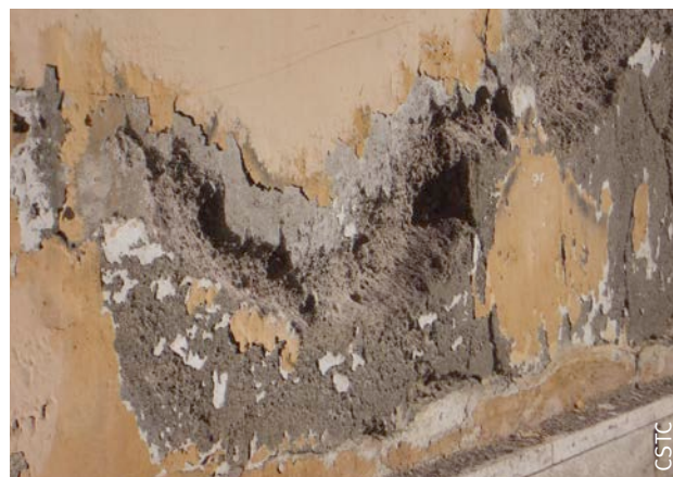
Fig. 10 Pulvérisation d'un enduit extérieur. Les symptômes décelés résultent de la cristallisation des sels solubles entraînés dans la maçonnerie par absorption capillaire de l'humidité présente dans le sol.
