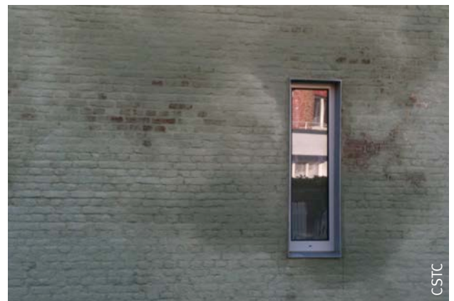
Fig. 29 Taches d'humidité et pulvérulence des finitions extérieures, liées notamment à la présence de nitrates dans la maçonnerie.
