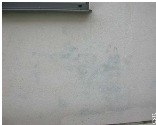
Fig. 62 Décoloration d'un système d'enduit sur isolant (EPS, 10 cm d'épaisseur), due à la migration de nitrates contenus dans la maçonnerie sous-jacente.
