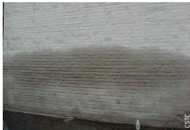
Fig. 64 Humidité résiduelle après un traitement de blocage de l'humidité ascensionnelle, due à l'action de sels hygroscopiques se trouvant dans la maçonnerie.
