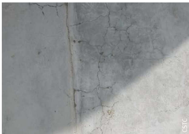
Fig. 11 Fissuration et décollement de l'enduit d'un mur. Les symptômes observés résultent de l'action des cycles de gel-dégel sur la maçonnerie qui a été humidifiée par l'infiltration d'eau de pluie.
