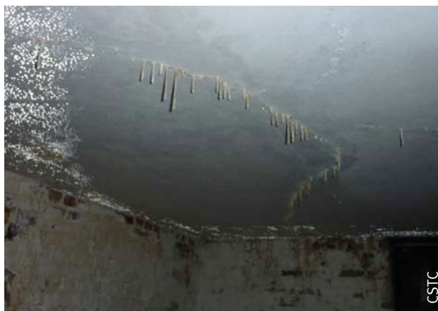
Fig. 14 Dégradation et condensation à la surface d'une dalle de béton constituant le plafond d'une cave. Les symptômes décelés (formation de stalactites) sont dus à l'infiltration d'eau de pluie par des fissures présentes dans la dalle de béton. La condensation se forme en raison d'une humidité relative de l'air élevée dans la cave et d'une température de surface du plafond très basse.
