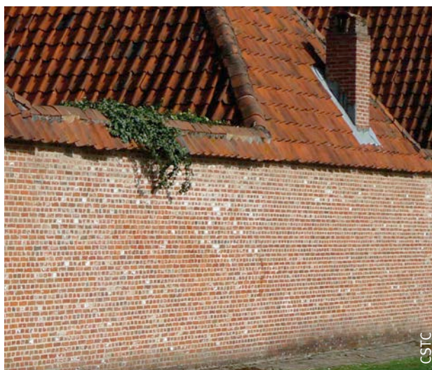
Fig. 37 Projections d'eau au bas de murs dépourvus de gouttière : les projections sont plus marquées sous les versants de toiture que sous les couvre-murs de clôture, car les quantités d'eau évacuées y sont plus importantes.
