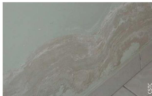
Fig. 33 Dégradation des finitions due au pontage de la membrane d'étanchéité par l'enduit intérieur au bas du mur.
