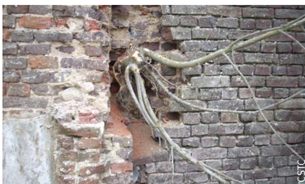
Fig. 2 Expulsion des éléments d'une maçonnerie. Les symptômes constatés ont été provoqués par l'action mécanique des racines d'un arbuste ayant pu s'implanter dans la maçonnerie grâce à la présence d'humidité.
