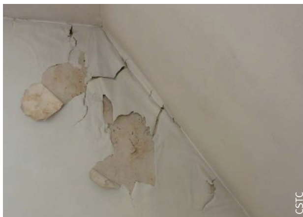
Fig. 12 Décollement du feuil d'une peinture. Les symptômes observés sont liés à une infiltration d'eau de pluie dans la maçonnerie du pignon.
