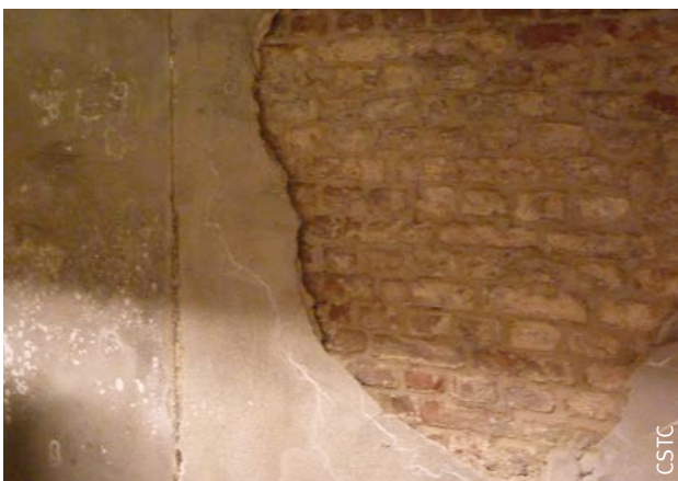
Fig. 9 Décollement d'un enduit appliqué sur un mur de cave. Les symptômes observés sont dus à l'action combinée de l'humidité en provenance des terres en contact avec la maçonnerie et de la cristallisation des sels solubles.
