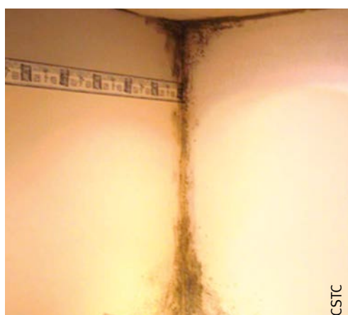
Fig. 17 Développement de moisissures dans l'angle d'une pièce utilisée comme chambre à coucher. Les symptômes observés sont dus à des températures de surface plus faibles dans l'angle de la pièce et à une humidité relative de l'air intérieur élevée.
