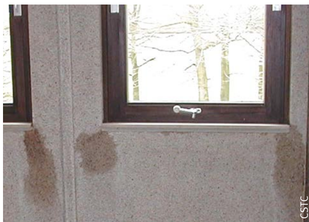
Fig. 31 Infiltrations d'eau au droit des menuiseries.
