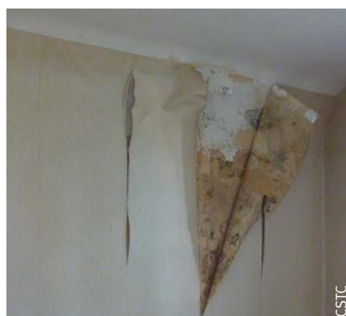
Fig. 18 Développement de moisissures à l'arrière d'un papier peint. Les symptômes relevés résultent d'une infiltration d'eau dans la maçonnerie et d'une forte étanchéité à la vapeur du papier peint.
