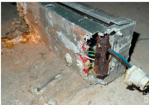
Fig. 7 Corrosion de la protection métallique d'un élément d'éclairage situé dans une cave. Les symptômes relevés sont dus à l'action des sels solubles et de l'humidité qui sont contenus dans les voûtes en maçonnerie et qui tombent sur les éléments métalliques par pulvérisation du mortier.
