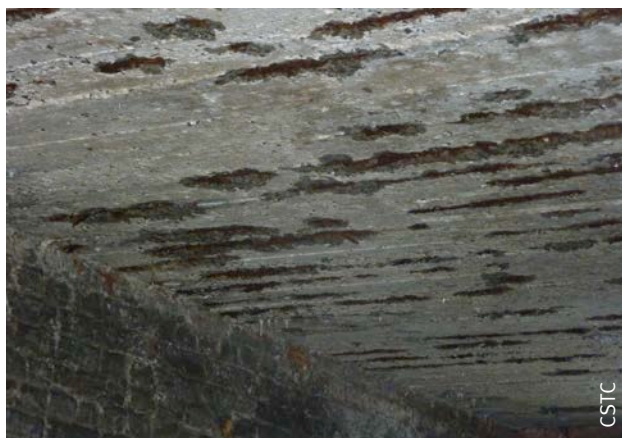
Fig. 13 Effritement de la couche inférieure d'une dalle de béton constituant le plafond d'une cave. Les symptômes observés sont dus aux tensions créées par la corrosion des armatures métalliques résultant, par exemple, de l'infiltration d'eau de pluie dans la dalle de béton.
