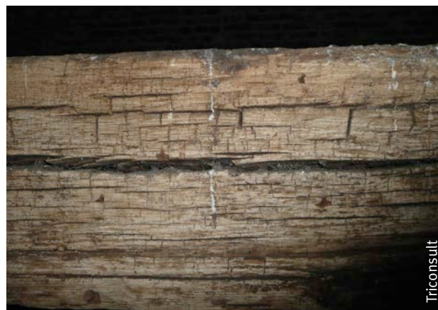
Fig. 8 Pourriture cubique ou pourriture brune du bois. Les symptômes constatés sont liés à l'action d'un champignon tel que la mērule. Celle-ci peut se développer même à grande distance d'une source d'humidité, à laquelle elle accède grâce à des rhizomorphes conducteurs capables de traverser les maçonneries.
