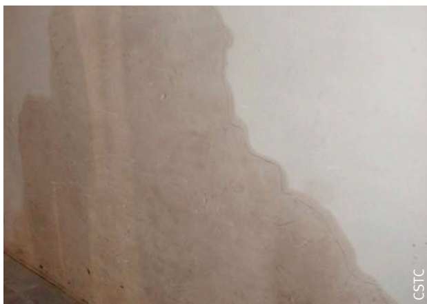
Fig. 5 Tache d'humidité apparaissant sur un enduit intérieur et fluctuant en fonction de l'humidité relative ambiante. Les symptômes relevés sont provoqués par les sels hygroscopiques contenus dans la maçonnerie sous-jacente.
