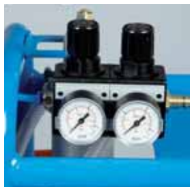
Manómetro no redutor de pressão para os componentes A + B e bomba de lavagem
